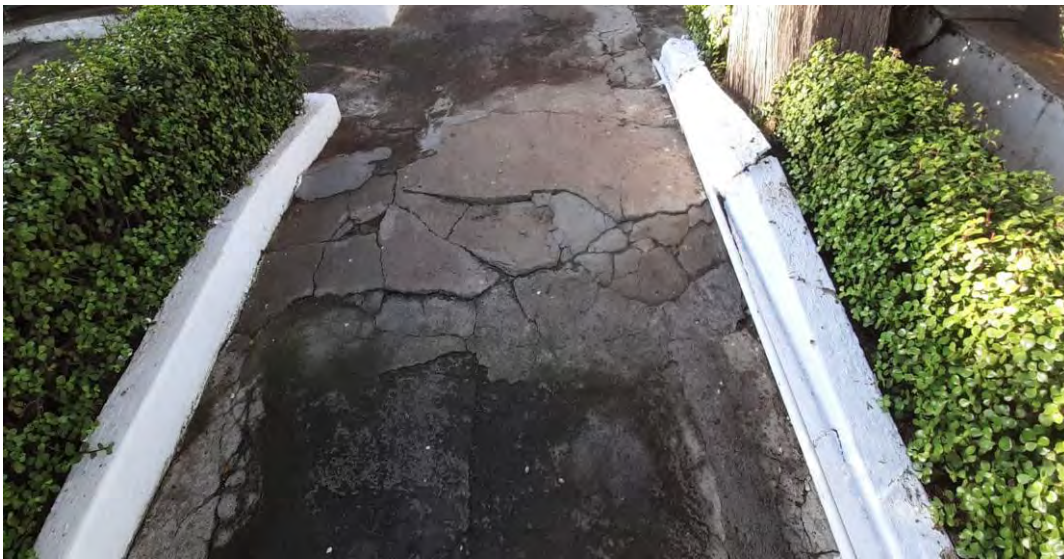
Situación anterior del pasillo de la entrada del Cementerio con el cemento cuarteado y muchas partes con elevaciones.
